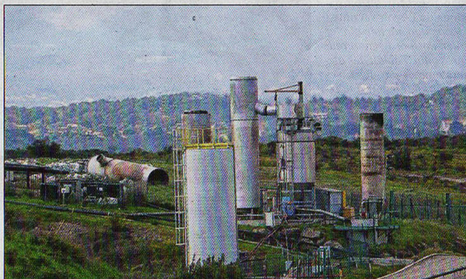
Les torchères du BGVap, unité de valorisation et de traitement des lixiviats installée sur le site fermé de La Glacière.
